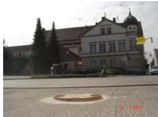
Thannhausen in der Bahnhofstraße, Einbau bei Sanierung Tragschicht: Budaplan Rahmen wird vor Einbau der 4 cm Verschleisschicht gesetzt.
