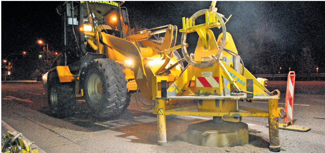
Die Fräse wird exakt über dem bisherigen Gullydeckel positioniert. Nach wenigen Minuten hat sie sich rundherum in die Fahrbahn gegraben.
