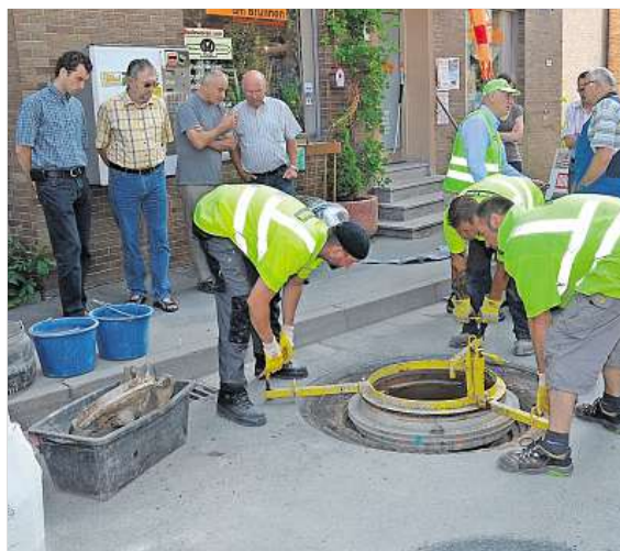
Auf der B 85 in Weißbrunn und Kronach wurde ein neues Kanaldeckelsystem installiert, um der Lärmbelastigung entgegenzuwirken. Das Bild entstand in der Ortsdurchfahrt Weißbrunn.
