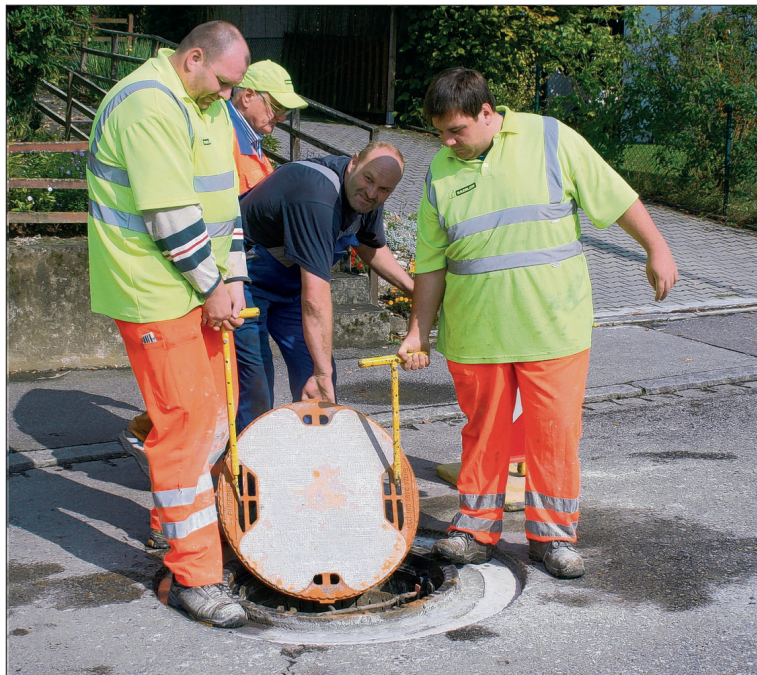
Die neuen, konischen Kanaldeckel sollen nicht mehr „rumpeln“. (Foto: fis)
