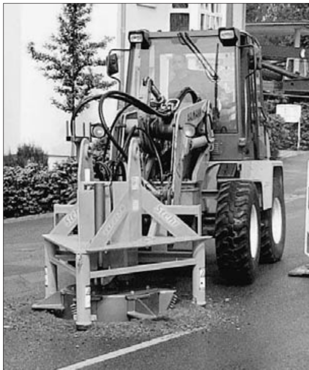
Balgheim hat jetzt neuartige Schachtdeckel installiert. Wenn Autos sie überfahren, klappern sie nicht. Viele Einwohner der Spaichinger Ortsdurchfahrt blicken neidvoll zum Nachbarort.
