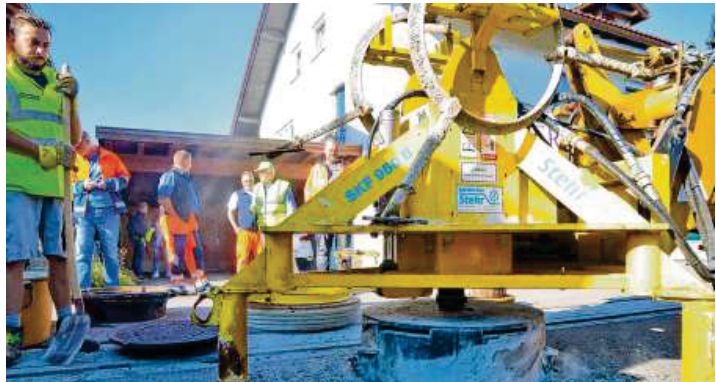
Eine neue Form von Kanalschacht hat eine Firma in der Illerstraße in Sonthofen eingebaut. Dort soll der Deckel nun längere Zeit nicht mehr klappern und Anwohner im Schlaf stören.
