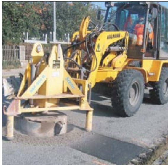
Die Bohrkronen, die an einem Spezialfahrzeug angebaut ist, frisst sich in die Asphaltsschicht. Fotos: Nicklas
