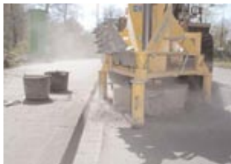
Abb 3: Ausfräsen der Schachtabdeckung und der Deckschicht mit Hilfe einer Kanaldeckelfräse [SKF der Fa. Stehr, Schwalmatal]
