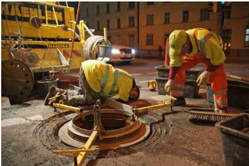
Feinarbeit zwischen 22 und 5 Uhr: Arbeiter positionieren in der Arnulfstraße einen Schachtrahmen. Foto: Daniel von Loeper
