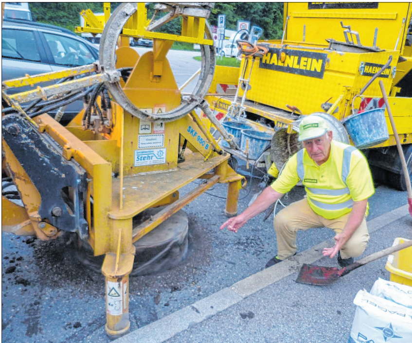
Do schau her: Claus-Dieter Haenlein zeigt dem »Anzeiger«-Fotografen, wie der neue Schachtdeckel in die Bahnhofstraße eingebaut wird. (Fotos: Wechslinger)
