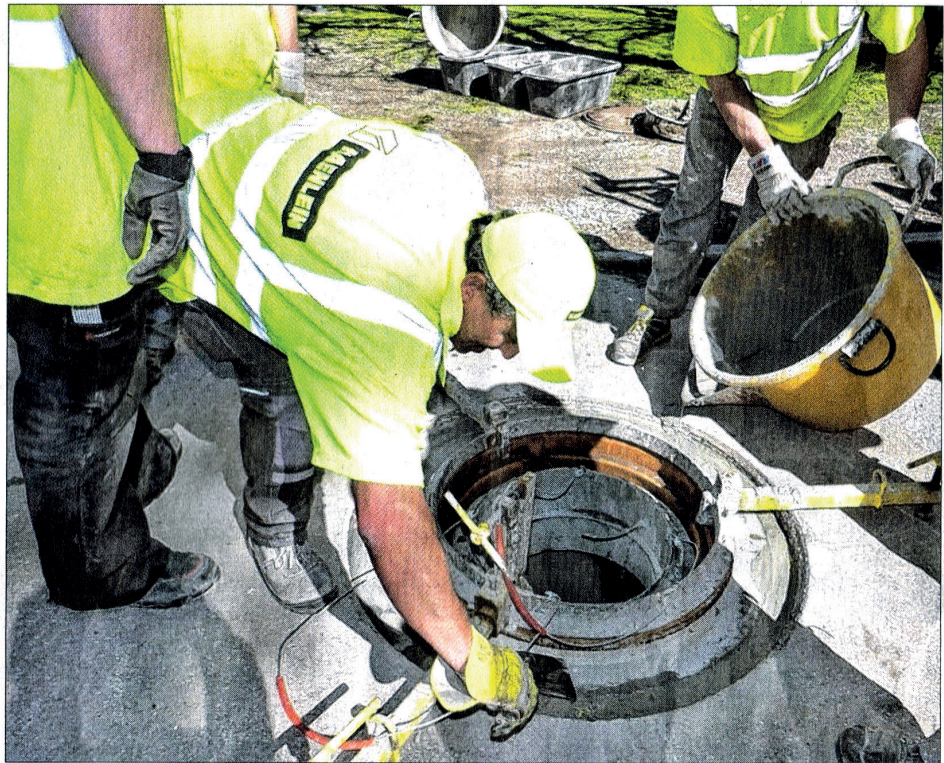
Neue Kanaldeckel in der Gemeinde Bergen sollen über Jahre hinweg »rumpelfreien« Verkehr ermöglichen. Bergen ist die erste Gemeinde im Landkreis Traunstein, die das neue Kanaldeckelsystem ausprobiert. (Foto: Müller)
