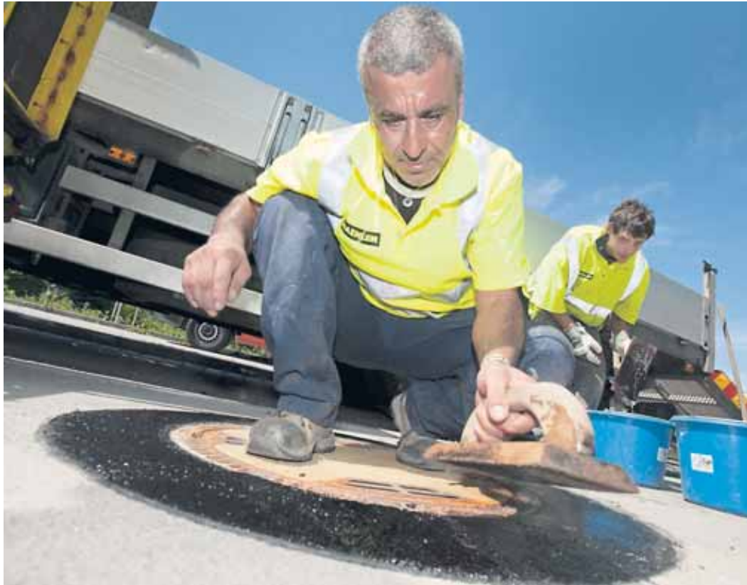
Wie ein Stöpsel in der Badewanne: Mesut Aksu schließt die Fugen der neuen Kanaldeckel in der Alten Landstraße in Ottobrunn mit einer Teerschicht.
