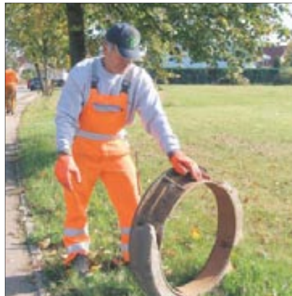
So sahen die ausgebauten Abdeckungen zum Teil aus.
